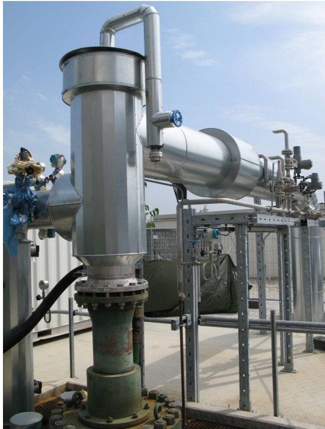
Figur 5: Brunnenkopf des Geothermie-Kraftwerks Unterhaching, Südbayern. Die Gesamthöhe beträgt ca. 3 m.
