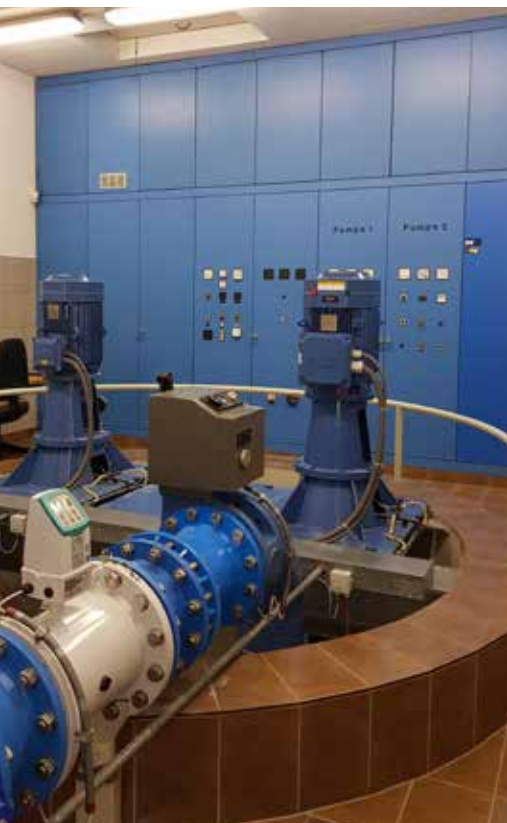
Die Pumpen der Grundwasserfassung Widen
